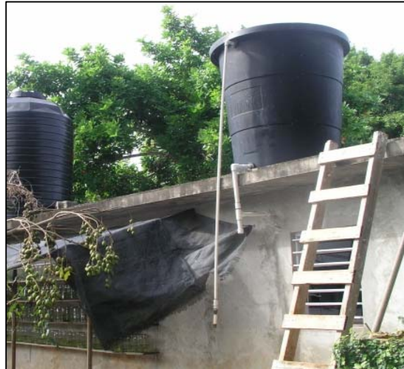
Tanque de Almacenamiento
