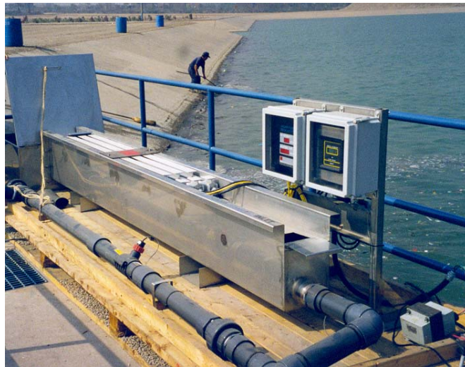
Sistema de tubos paralelos al flujo instalado en una planta potabilizadora
