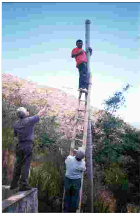
Foto 4. Cableado eléctrico para abastecer de energía a la fuente de producción del desinfectante
