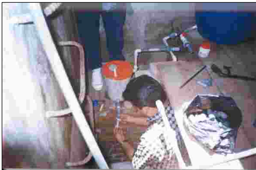
Foto3. Conexiones de distribución del desinfectante hacia el dosificador y sistema de drenaje de los recipientes de producción.
