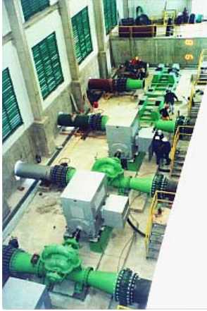
Figura 6: Estação elevatória de água bruta.
