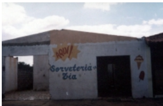
Figura 11 – Residência com estrutura comprometida interdita
